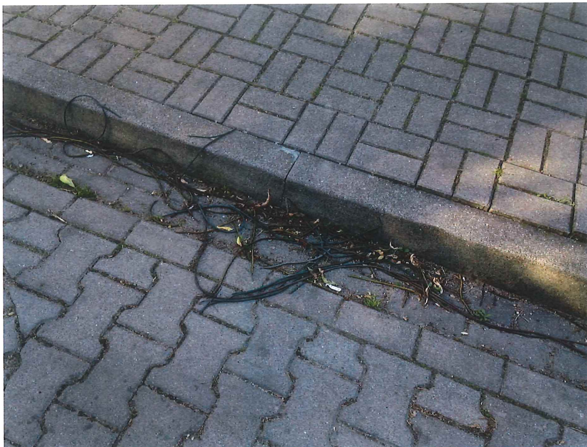
Fot. 4. Kable i inne śmieci zapychające studzienki odwadniające.
